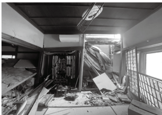
④ 柱の著しい傾斜
