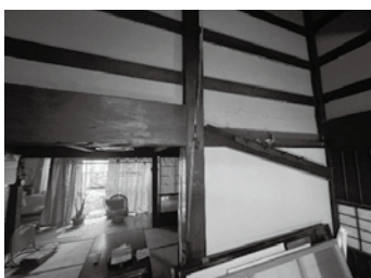
② 柱の割れ
