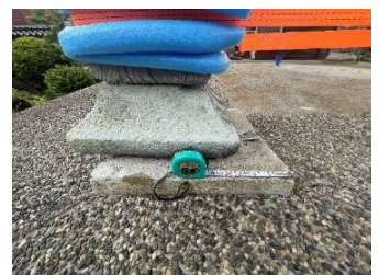
写真4 ロッキング による礎盤ずれ (G)
