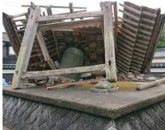
写真1 軸部のせん断変形 による倒壊 (A)
