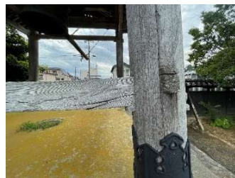
写真2 軸部のせん断変形 による貫の破損 (B)
