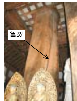
写真2 心柱根元の亀裂
